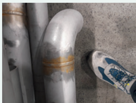
▲ Exemple d'un cordon soudure brossé mais pas traité chimiquement présentant un départ de corrosion
